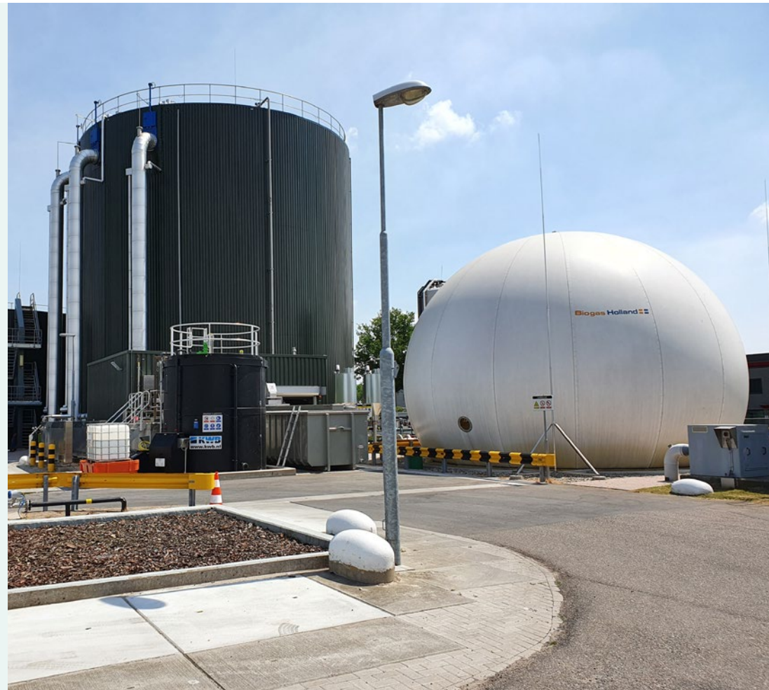
13 Slibgisting en biogasinstallatie op RWZI Tiel
